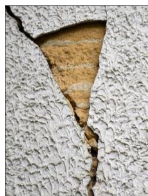
Très souvent, les anciens murs en pisé ont été recouverts par des enduits en ciment : grave erreur !
